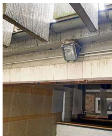
Vögel nisten in Ecken der Schießanlage. Oben sind Teile der Lärm-schutzvorrichtung zu sehen.
